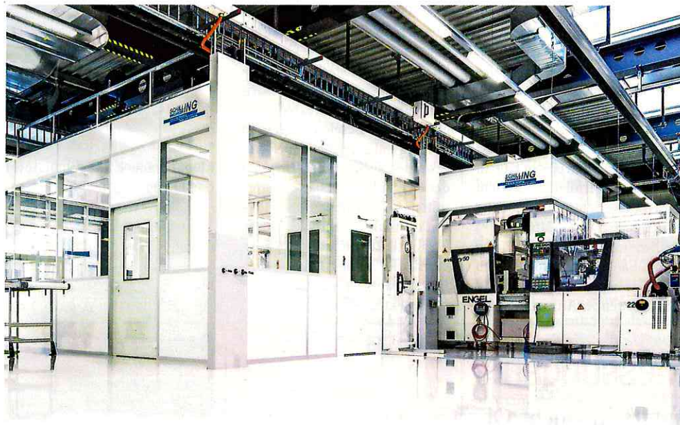
Das Reinraumsystem Cleancell 4.0 der ISO-Reinraumklasse 7 ist für das Spritzgießen geeignet.
