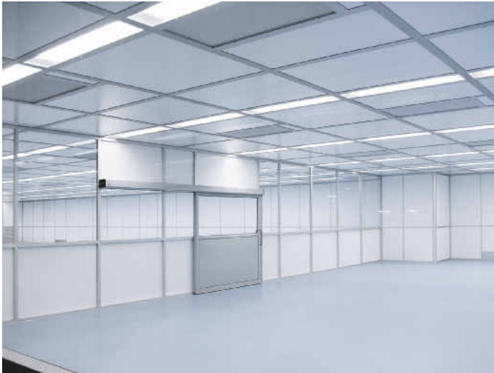
GMP-Wandsystem von Schilling Engineering – in den Wandmodulen sind die Umluft- und Rückluftführung integriert
